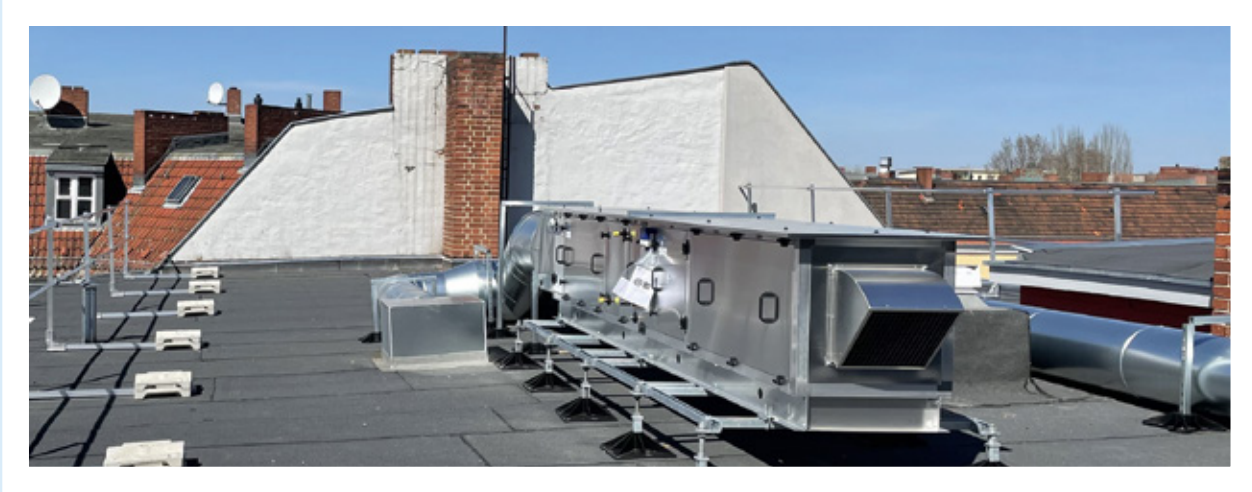
Abluftanlage Harzer Str. 38
