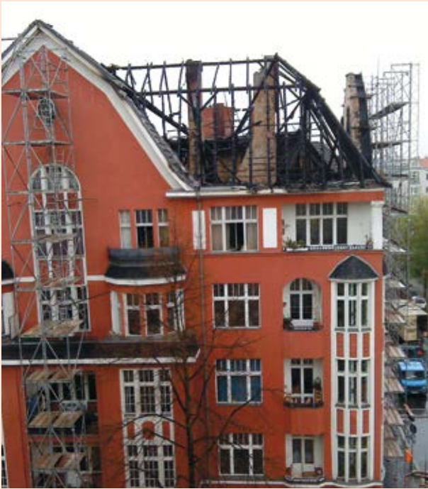
Brandschaden im April 2008, Harzer Straße 15, 16 und Bouchéstraße 42
